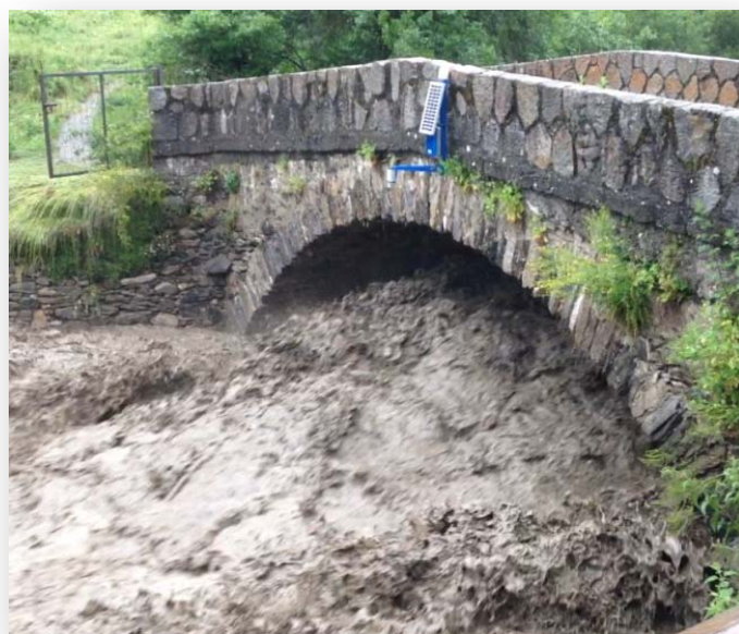
Estación de Sensores SmartyRiver400 sobre el puente de Escunhau en el momento de de la avenida
